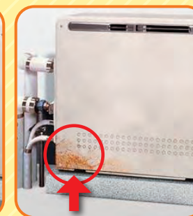
外装が錆で損傷
