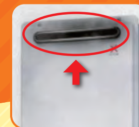
排気口に煤汚れ
